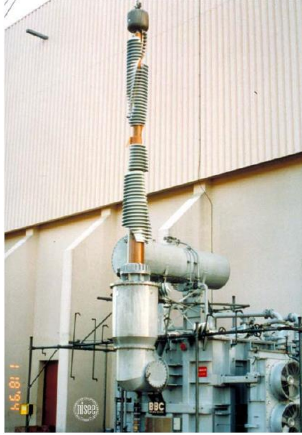
الشكل (2) تحطم البورسلان في محول ( 400/220kV )
