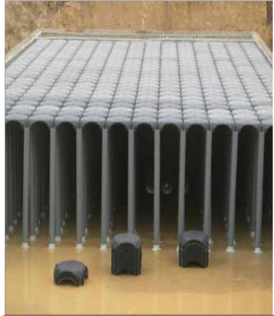
خزان تجميع مياه تحت منطقة صناعية
