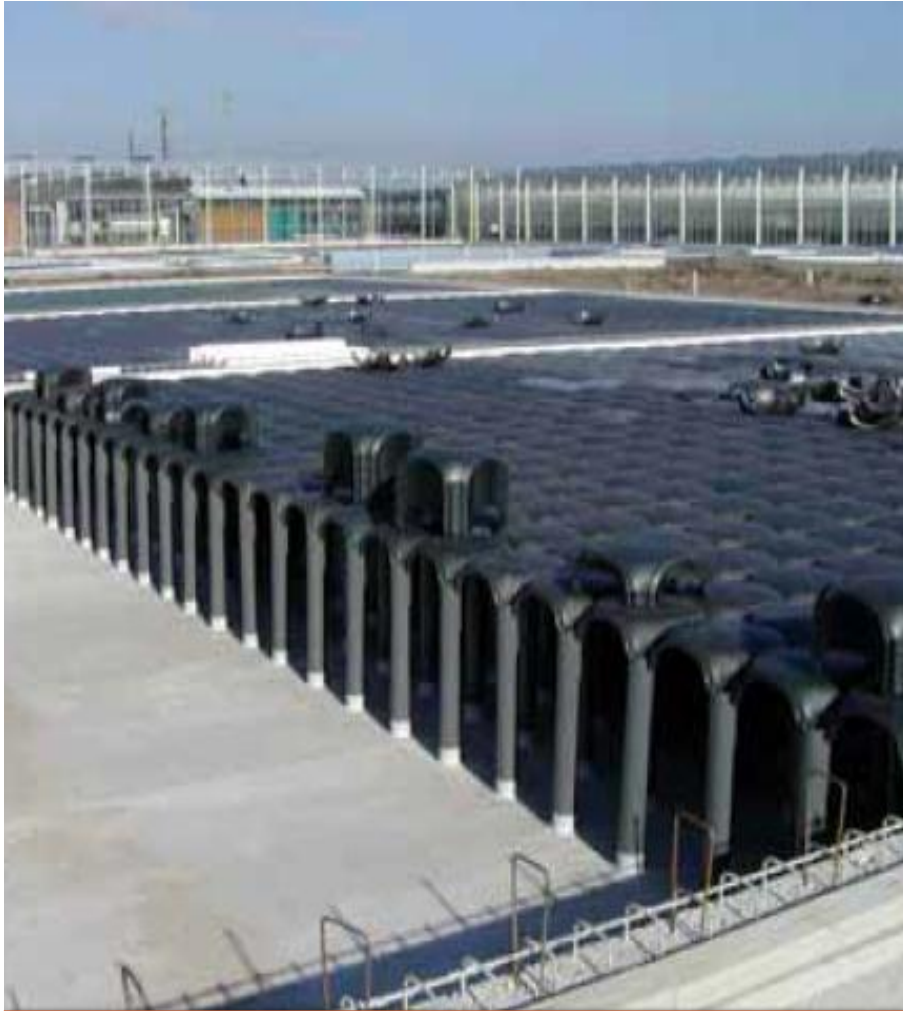
خزان تجميع مياه في مشتل
