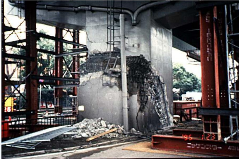
الشكل (2-37): تأثير المركبة الشاقولية للزلزال وانهيار ركيزة جسر الطريق السريع
