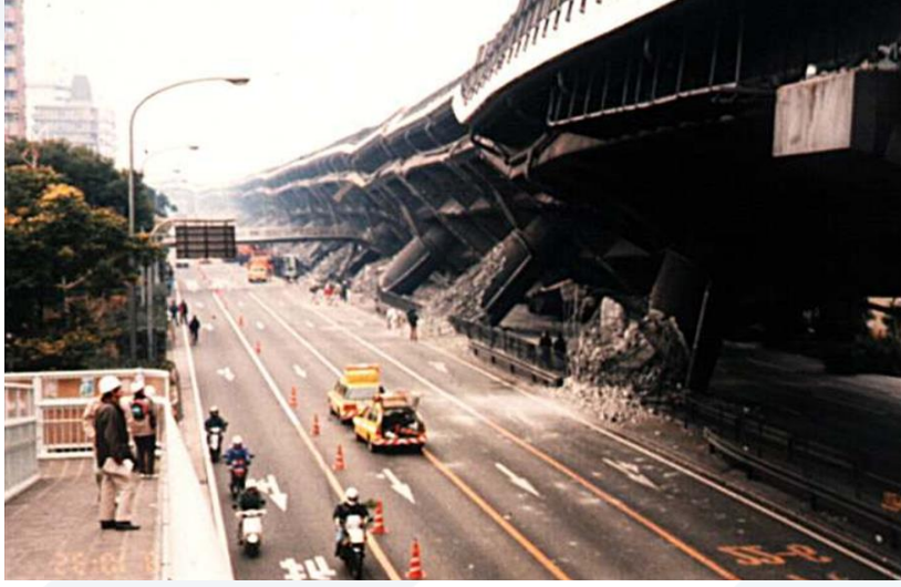
الشكل (2-36): تأثير المركبة الأفقية الكبيرة للزلزال وانهيار جسر الطريق السريع
