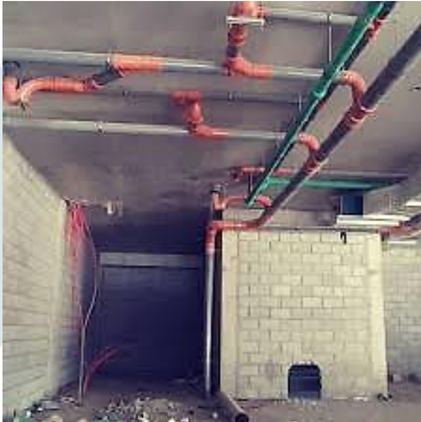
شبكة الصرف الصحي المعلقة في السقف
